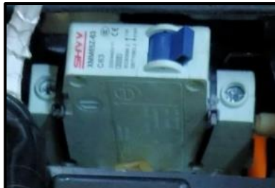
Gambar 5 MCB Motor Listrik Konversi
