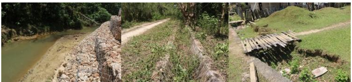
Gambar 3. Kondisi Eksisting Infrastruktur Drainase Primer dan Sekunder
